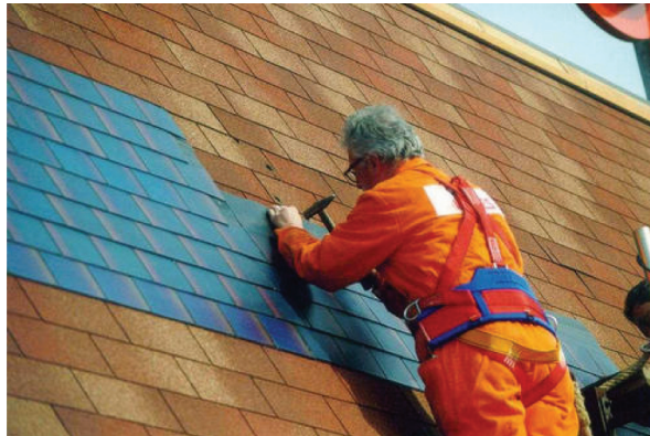
Figura 15 – Módulo fotovoltaico integrado a fachada
